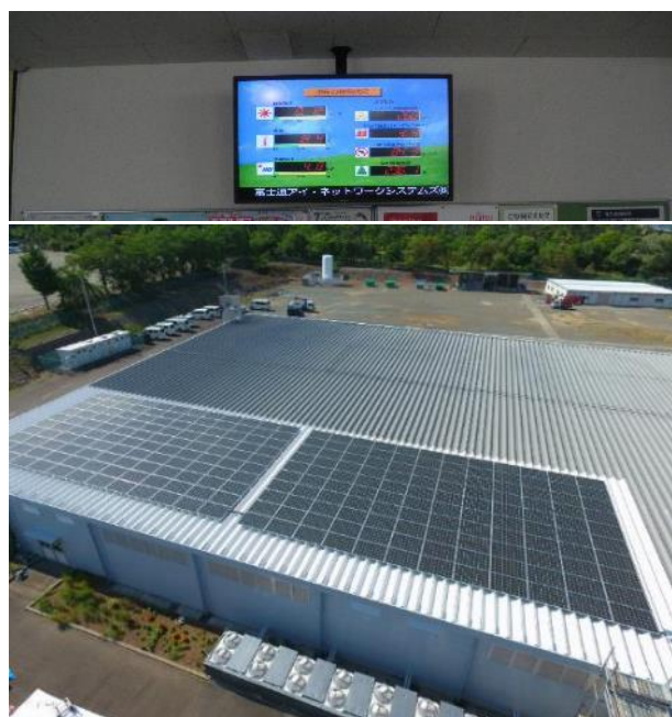
太陽光発電（2020年：北棟に移設）
