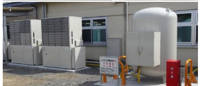
食堂新空調設備 自立型ガスヒートポンプ(GHP)
