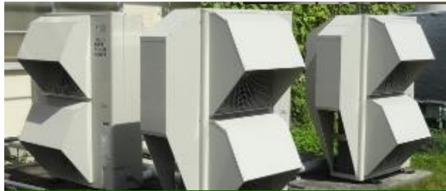
サーバー室の新空調機
