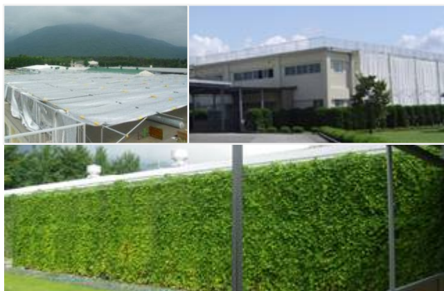
西1・2号棟の緑のカーテン／東棟の遮光カーテン
